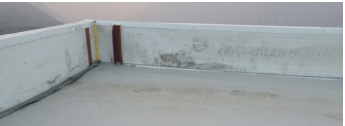
Отсутствует заведение мембраны на парапет.
