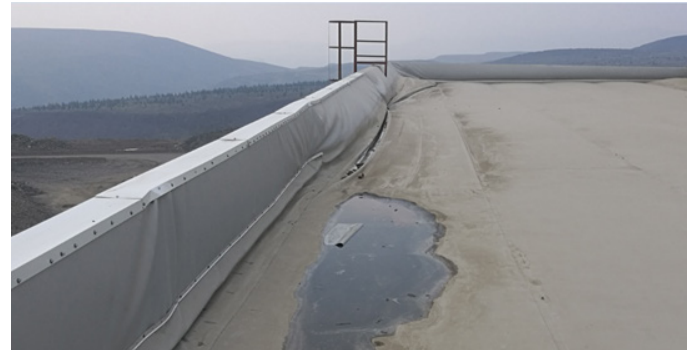
Не выполнены ветровые зоны (в данном случае отрыв мембраны в угловой зоне).
