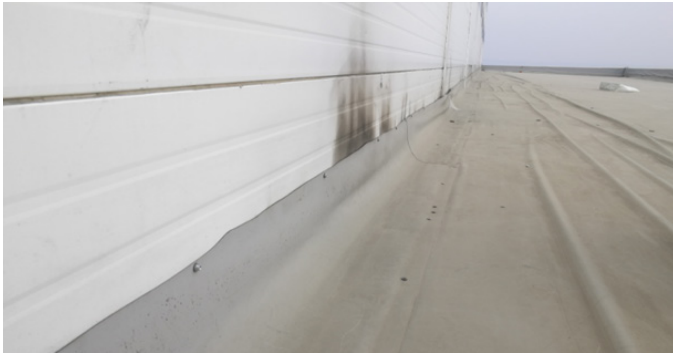
Отсутствует краевая рейка с гидроизоляцией шва полиуретановым герметиком.
